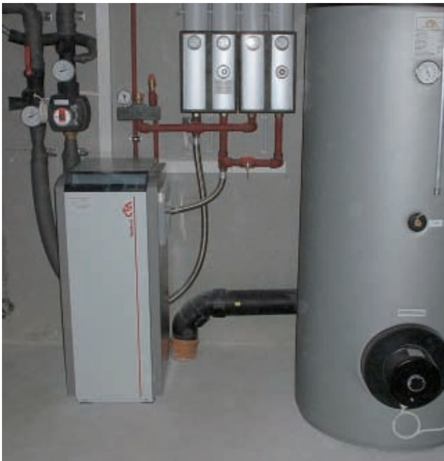
Einsatz einer effizienten Wärmepumpe im Keller eines Einfamilienhauses.
